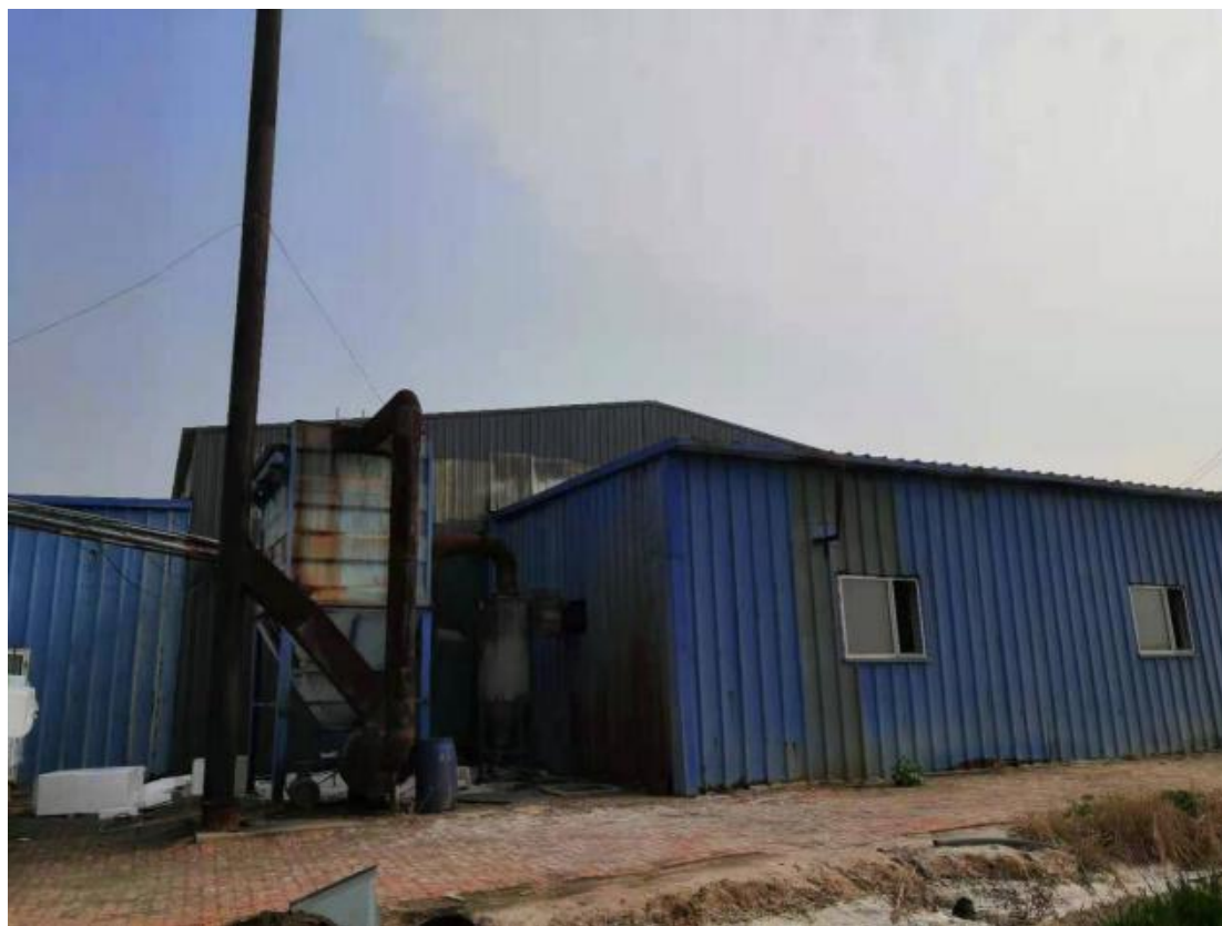
图 3-1 废气治理设施现场图
