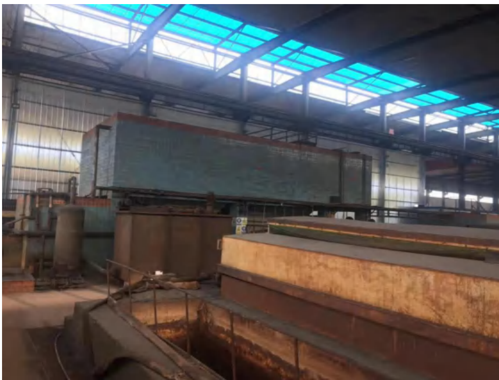
图 3-1 废水处理设施
