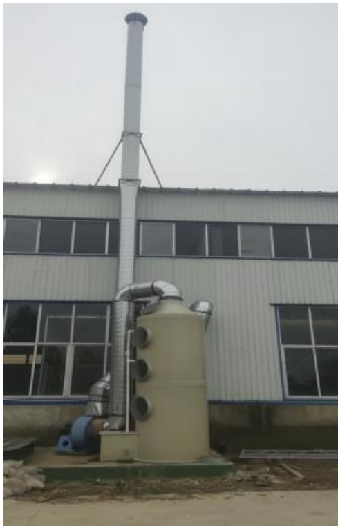
图 3-1 废气治理设施现场图
